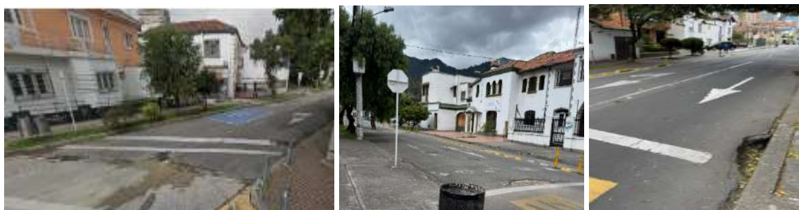
Imagen 38. malla vial con daños estructurales.
